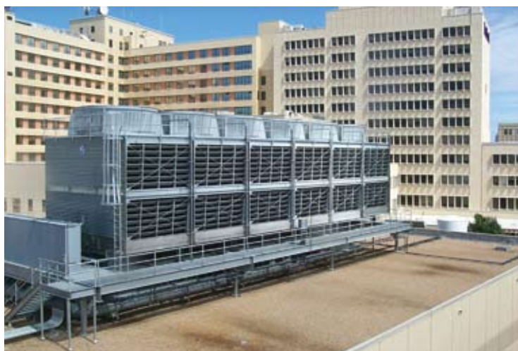
Figura 4: Condensador evaporativo localizado no exterior das instalações
